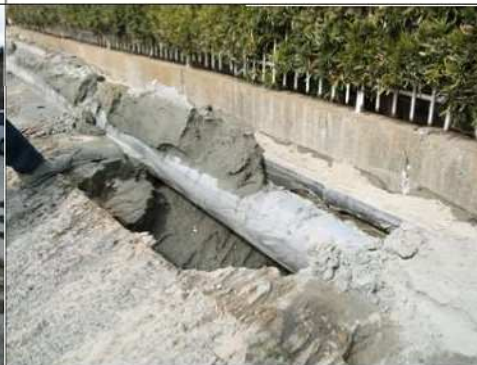
埋設配管の浮き上がり[2] (写真：国土交通省関東地方整備局)
