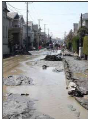
道路・宅地の被害[1] (写真：民間コンサルタント会社より提供)
