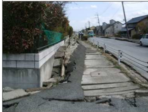
埋設配管の浮き上がり[1] (写真：国土交通省関東地方整備局)
