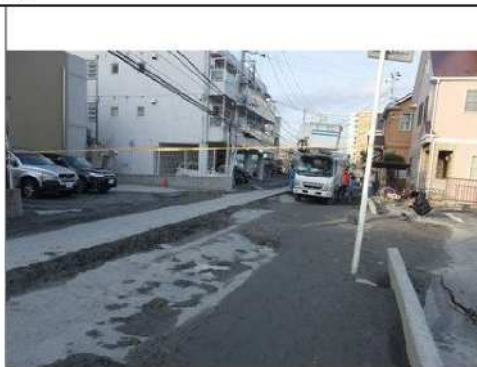
道路・宅地の被害[2] (写真：東京電機大学安田教授より提供)
