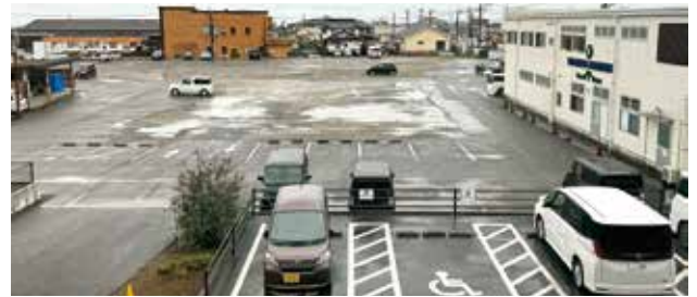
早急な舗装工事が待たれる町立病院外来駐車場
