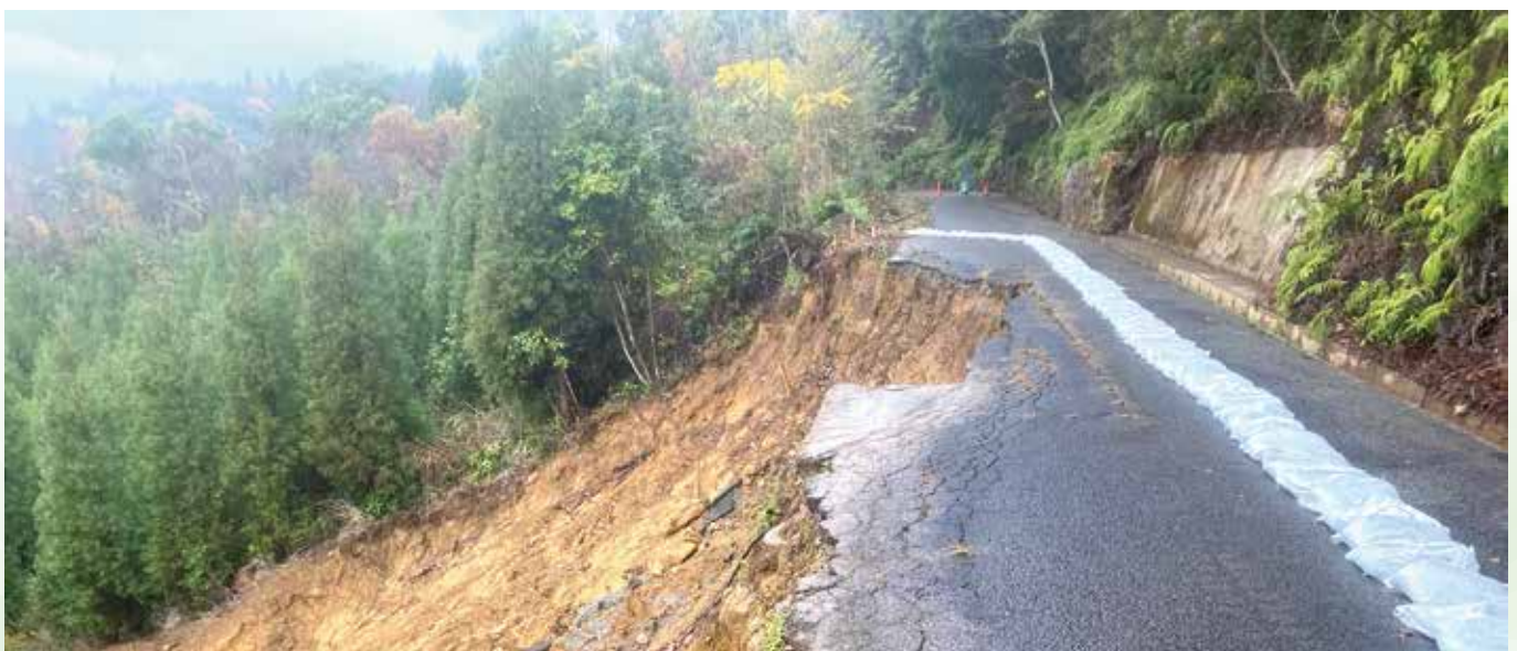
8月の豪雨で被災した平山11号線（内野々開パ道）
